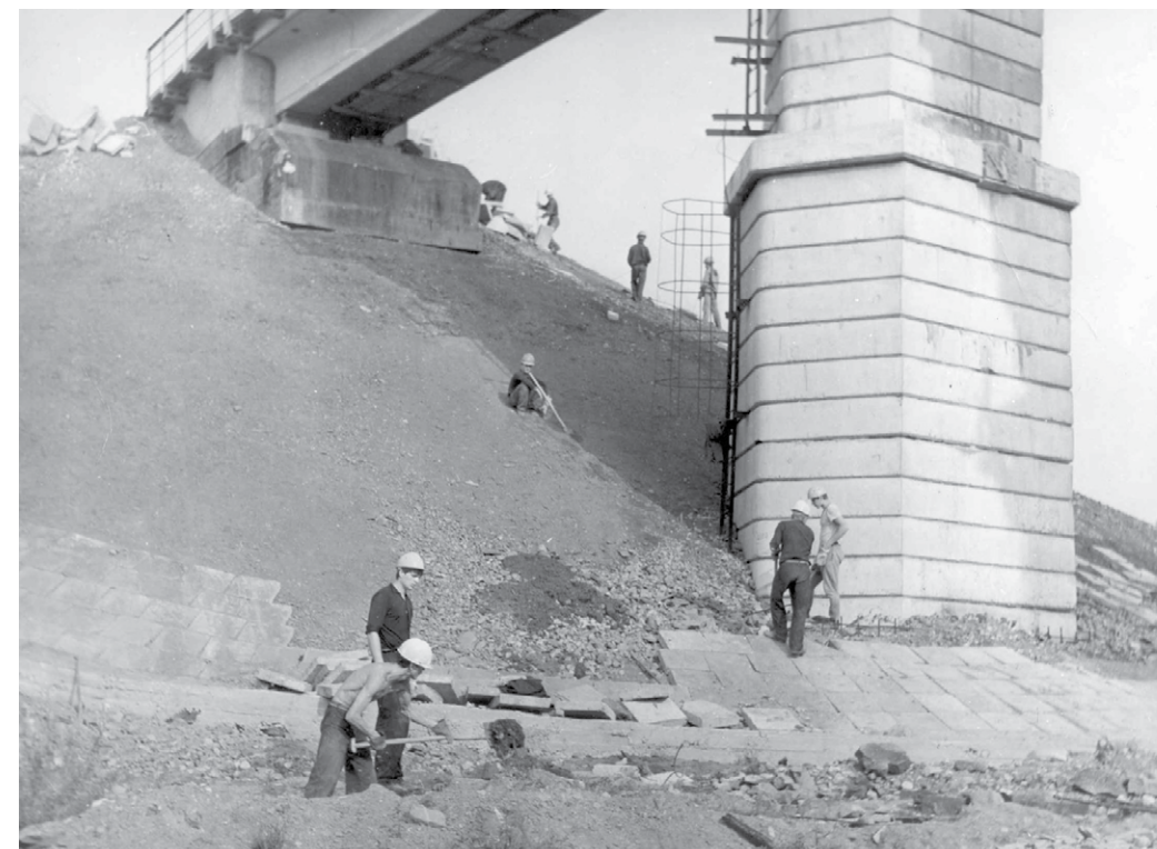
▶ Отряд «Альтаир» ПГМИ на строительстве подъездных путей к «Металону-700» в пос. Северный г. Губаха, 1984 г.
