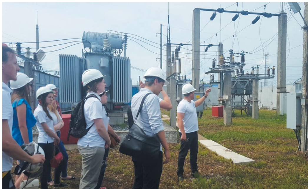
▲ ССО «Энергия», ПНИПУ, подстанция с. Култаево, работа на объектах филиала ОАО «МРСК Урала» – «Пермэнерго», 2018 г.
